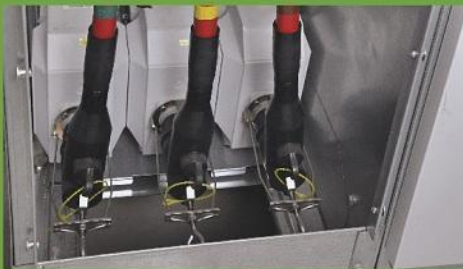
Zona de Cableado de Potencia (media tensión), en el gabinete de las nuevas celdas.
