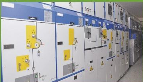
Frete de maniobra de las nuevas celdas modulares y compactas de 33 KV y de 13,2 KV.
