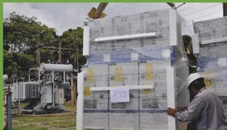
Descarga de las nuevas celdas modulares y compactas de 33 KV y de 13,2 KV.
