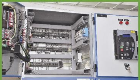
Cableado interno para protección, mando y señalización (baja tensión), en el gabinete de las nuevas celdas.
