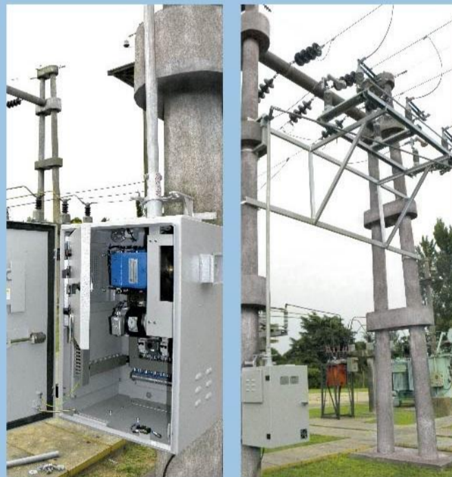
Comando motorizado de seccionador bajo carga, que vincula linealmente la barra I y II en la Estación Transformadora del Anexo II.
